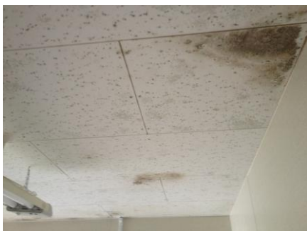
▲真っ黒なカビがはびこるキッチン の天井部。提供：NPO 法人石巻復興支 援ネットワーク（やっぺす）
