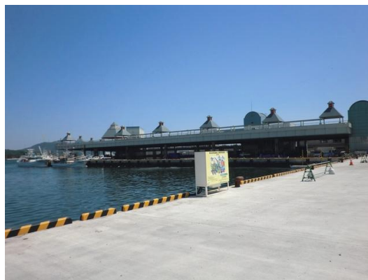
▲ことし 5 月に岸壁の復旧工事が終わった気仙沼魚市場。2013 年の水揚量は震災前の 66%にとどまる。
